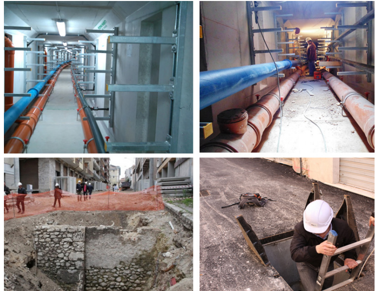
Fig. 4. Lo Smart Tunnel (AQ): galleria costituita da pezzi speciali prefabbricati assemblati in sito, all'interno della quale passano i principali servizi della città.
