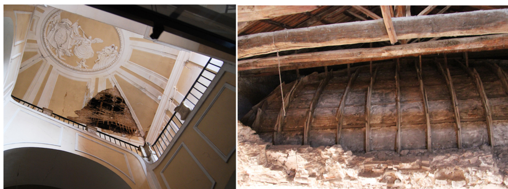
Fig. 56. Volta in cannucciato danneggiata dal terremoto del 2009 e volta a schifo fotografata durante i lavori di restauro.
